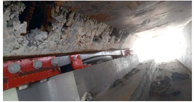
Figura 25. Sistema de gateo para la reparación y reemplazo del apoyo dañado en pila 5
