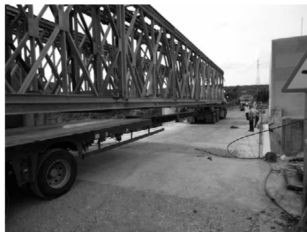
Figura 15. Movimiento de viga principal entre tableros
