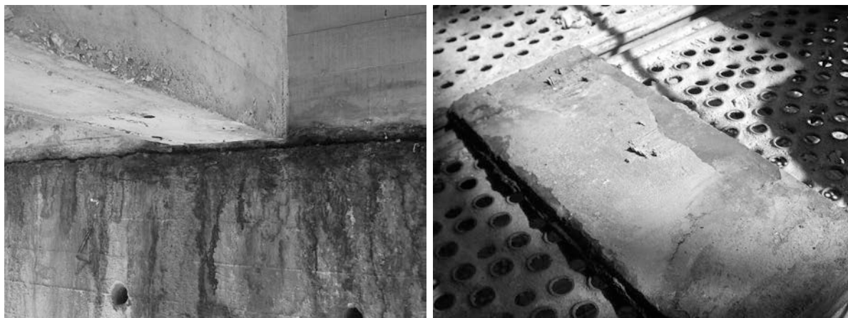
Figura 21. Estado de conservación de los apoyos de plomo
