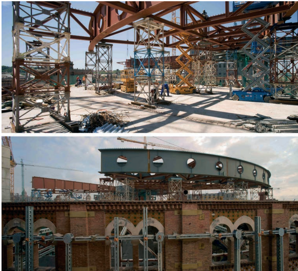
Figura 54. Montaje de platea mediante torre central y de vigas radiales y circunferenciales sobre cimbra Figure 54. Assembly of disc with central tower and radial and circumferential beams on falsework
