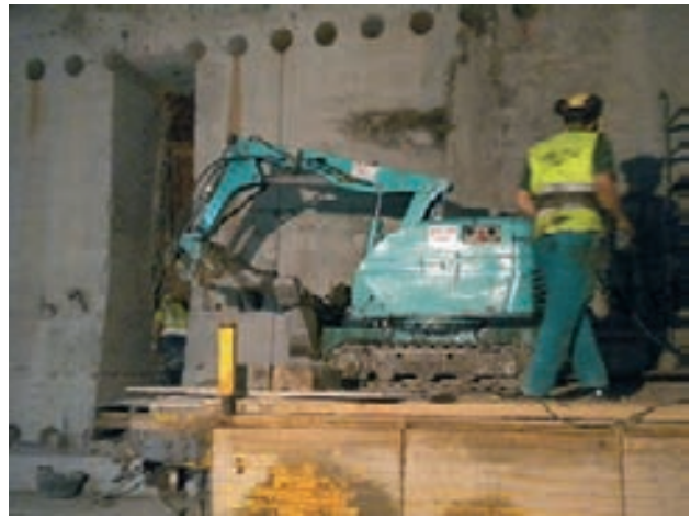
Figura 17. Demolición del hastial. Se aprecian las perforaciones y cortes verticales y horizontales
