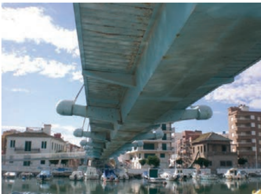
Figura 4. Aspecto en 2010 del tablero
