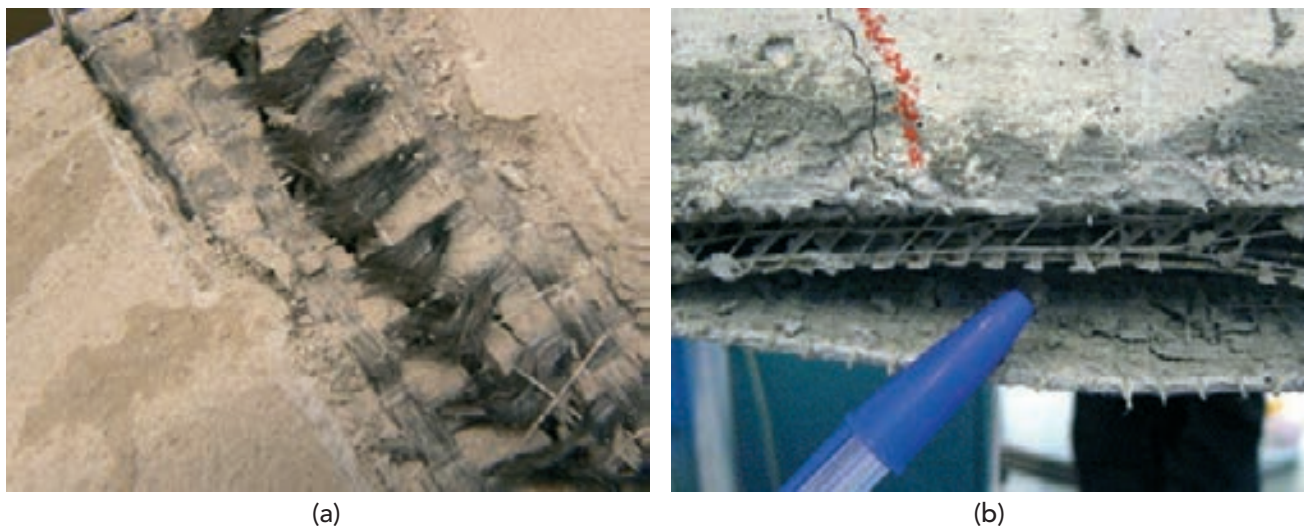
Figura 7. Rotura del tejido de fibra de carbono y despegue prematuro del TRM, localizado entre dos capas de refuerzo de acero
