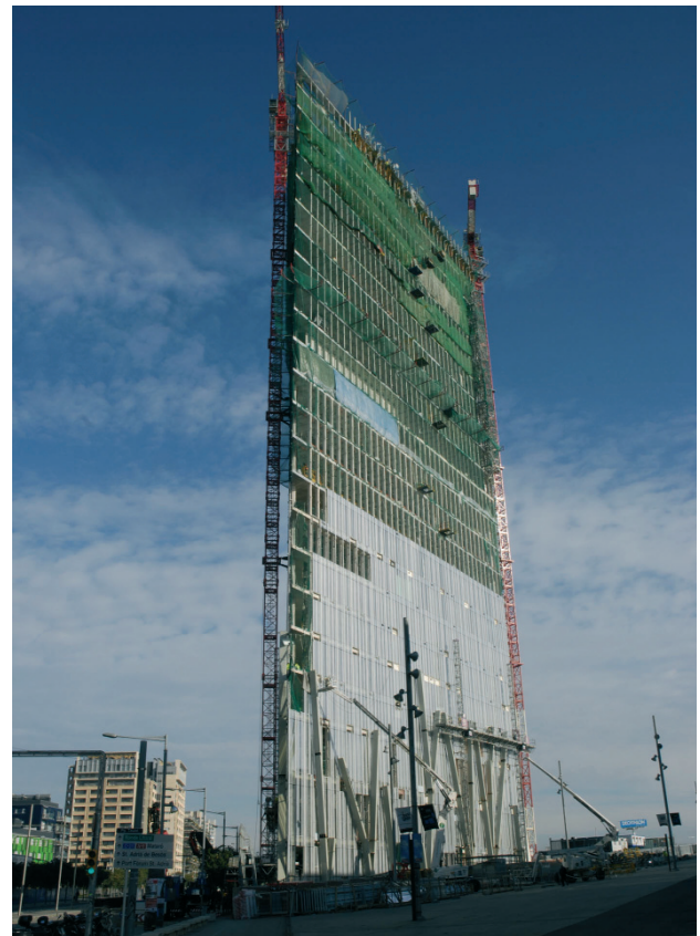
Figura 33. Vista del edificio en construcción con el importante desfase soporte-muro cortina-bamboos Figure 33. Building under construction showing the execution sequence columns-curtain wall-bamboos
