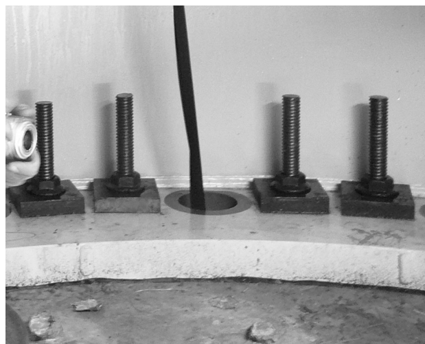
Figura 17. Torre de Hamina. Brida de conexión
