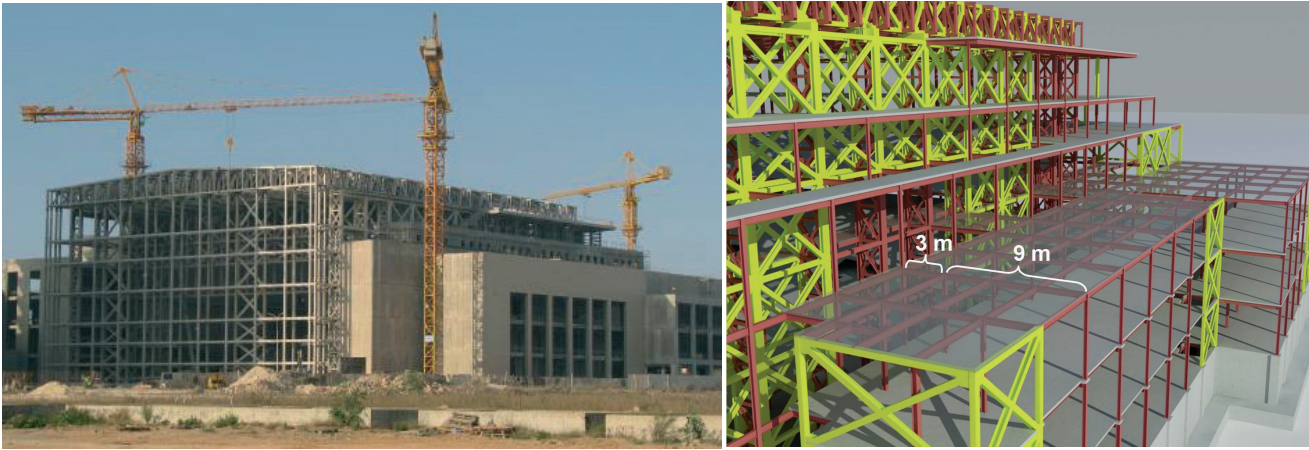
Figuras 25 y 26. Vista del edificio de oficinas a la derecha del auditorio (lado Oeste) y luces de vigas principales mixtas
