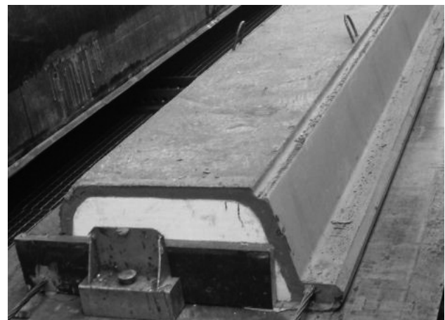
Figura 14. Sección del elemento pretensado, en la que se aprecia el poco recubrimiento del cordón en su parte superior
