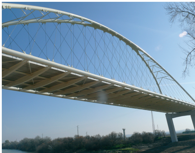
Figuras 45a y 45b. Vistas del sistema de arriostramiento de los arcos en el puente de Palma del Río.
