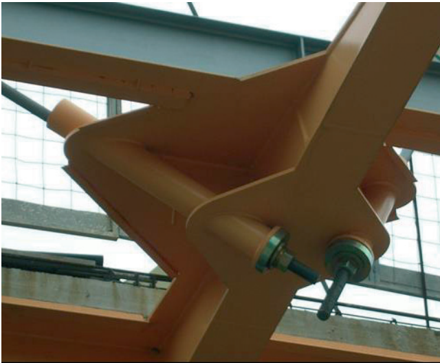
Figura 22. Detalle del extremo inferior de las péndolas Figure 22. Hanger lower anchorage close-up
