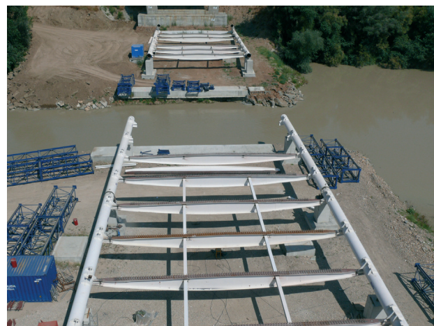
Figura 39. Vista de las penínsulas artificiales y de las labores de ensamblaje de la estructura metálica del tablero Figure 39. Artificial embankments and steel deck assembly operations
