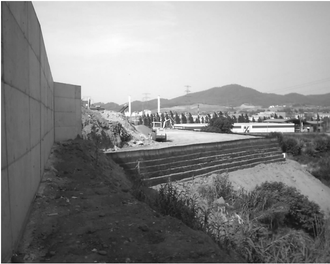
Figura 26. Muro ecológico de capas de tierra armada, para completar el solar de las pistas polideportivas.
