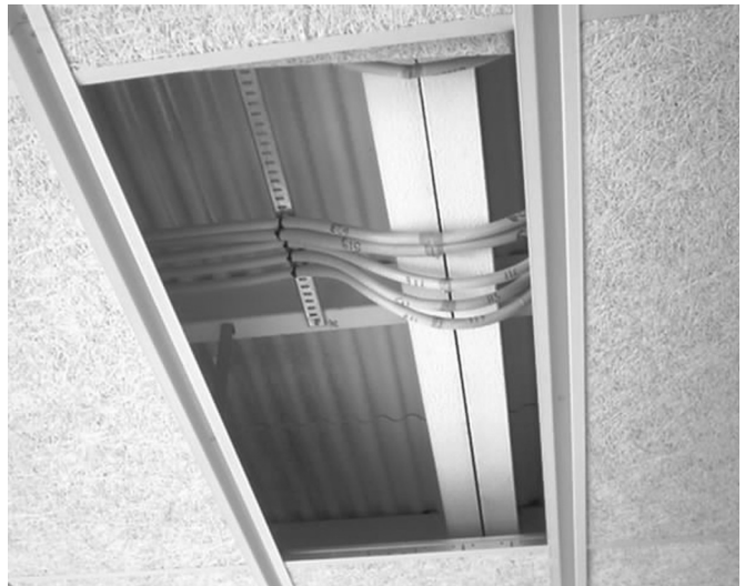
Figura 34. Conexión entre los módulos, que llegan equipados con todas sus instalaciones eléctricas y sanitarias.
