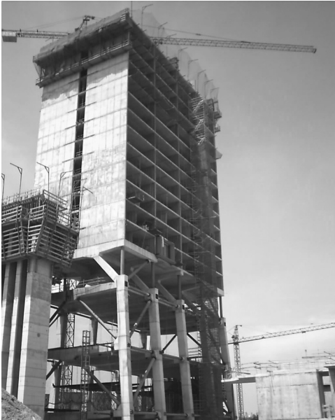
Figura 6. Hotel Hesperia. Estructura semiprefabricada de pantallas de hormigón in situ y prelasas ATEFOR. Arquitectura: R.Rogers y Alonso-Balaguer arqs. Estructura: R.Brufau y Ass.
