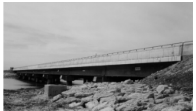
Figuras 11 y 12: Puente sobre el río Guadalete realizado con vigas de HAR tipo H-80.
