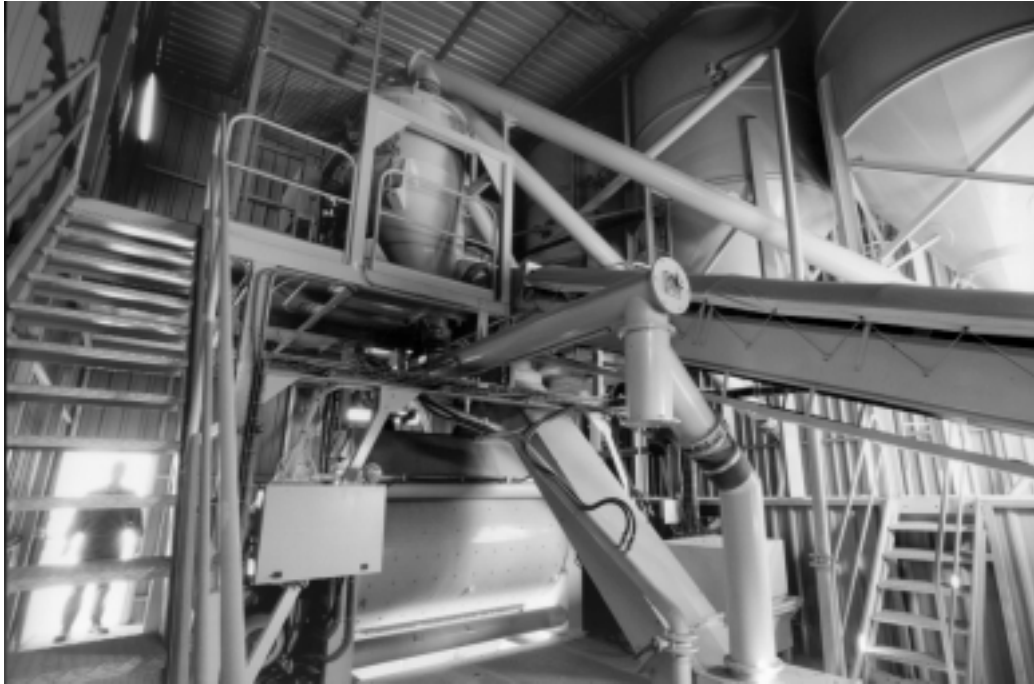
Foto 5: "Instalaciones de amasado".
