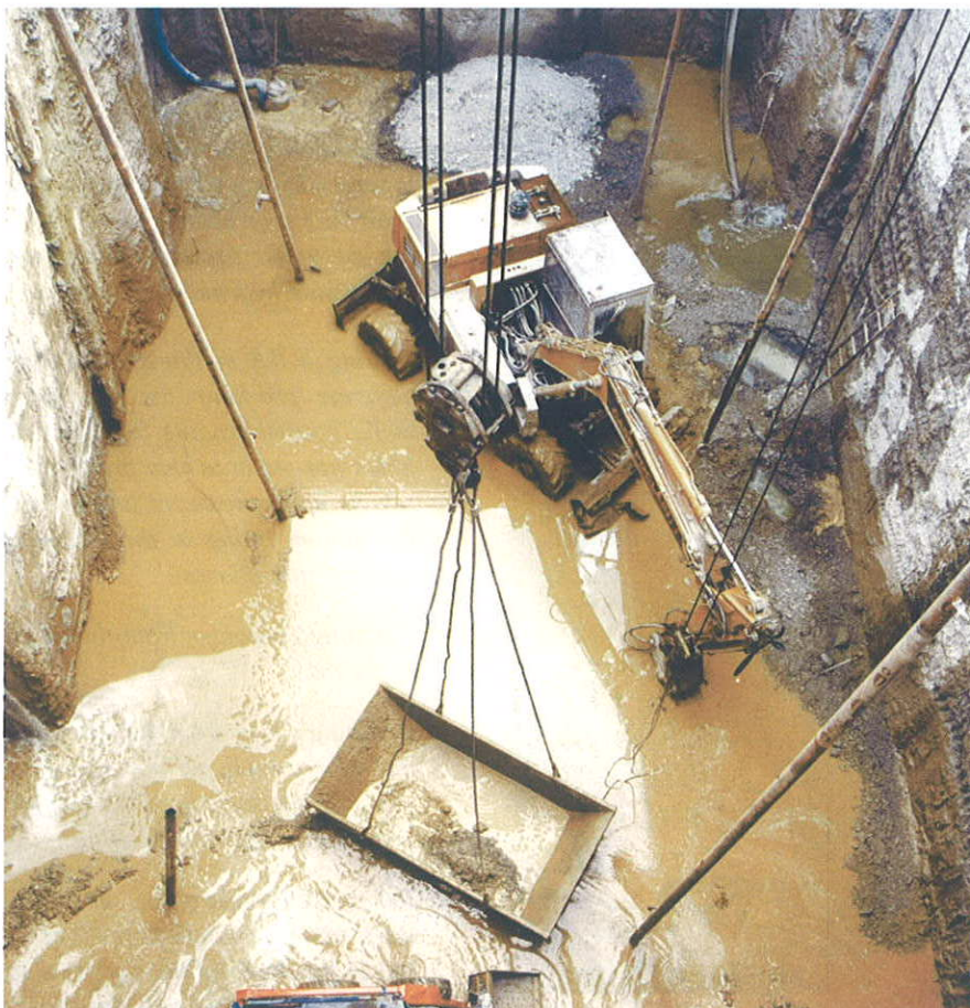
Fig. 20. Rozado y limpieza del foso. Fig. 20. Reshaping and cleaning of the pit.
