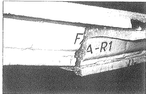
Forjado armado con refuerzo superior. Rotura por agotamiento de la armadura de tracción.
