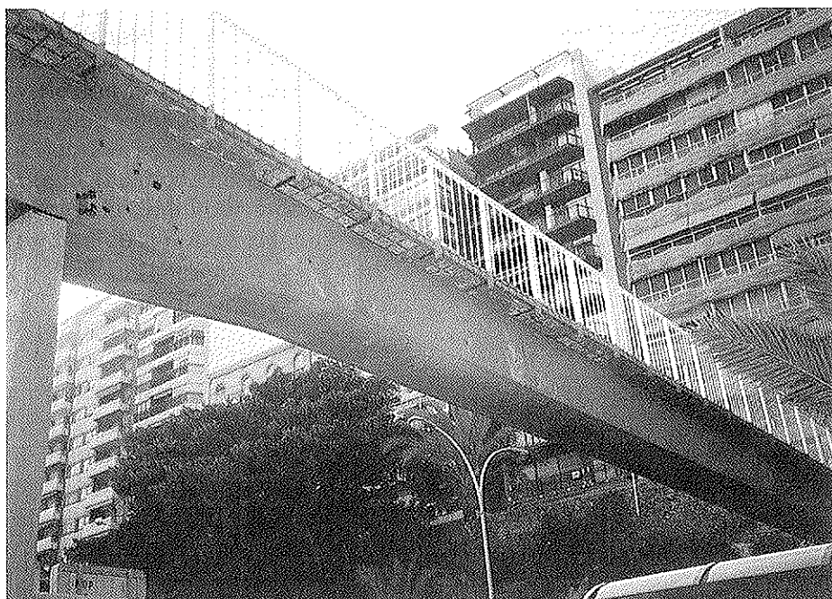
Fig. 2. Detalle de la pasarela antigua deteriorada.
