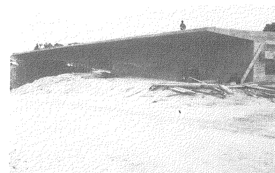
Fig. 38. Vista de uno de los tableros descimbrado con detalle del vano de compensación.
