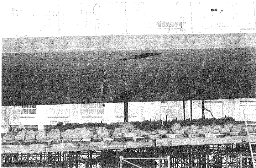
Fig. 7.32. Fisuración alcanzada durante la prueba. Mitad lado Besós.
