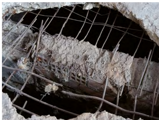
Figura 26. Viga de cuelgue en la losa de planta baja en la nave central, sobre la Capilla de sótano, con un tramo de hormigón "sustituido" por ladrillos hueco doble.
