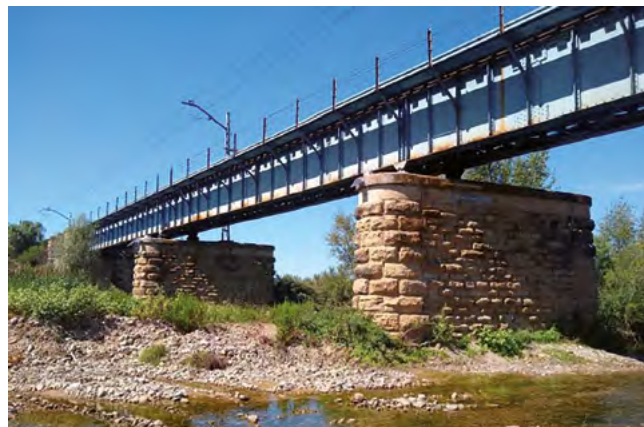
Figura 7. Vista general de equipos instalados en pilas del tramo metálico sobre el río Leza PK 065/097 línea Castejón-Bilbao. (Fuente: Tecsca-UPV).
