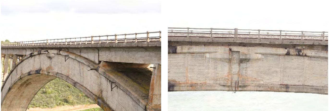
Figura 10. Vista general y de detalle de la zona de la clave del arco central del viaducto Martín Gil. (Fuente: Ineco).
