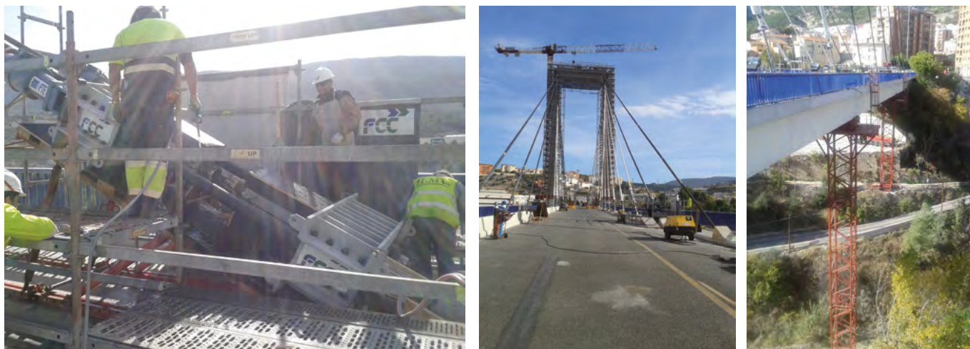
Figura 7. Puente atirantado de Alcoy. Plataforma de tablero en obras (izquierda). Torres de apeo de tablero (centro). Detalle del sistema (by-pass metálico) de corte y destesado controlado de tirantes (derecha).
