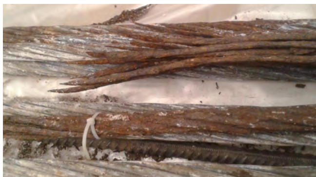
Figura 5. Detalle de cables de acero corroídos en tirante roto, en zona sin protección de lechada.
