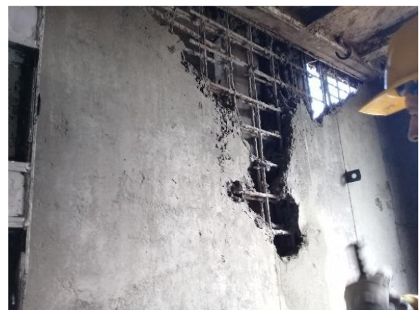
Figura 2. Problemas en el vaciado del concreto.
