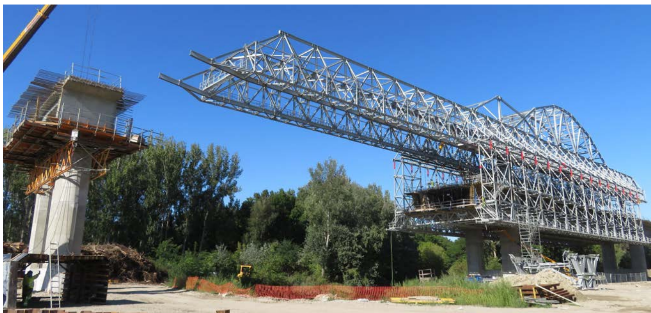
Figura 6. Vista general de la autocimbra sobre el tablero. A la izquierda se observa una dovela 0 sobre pila.
