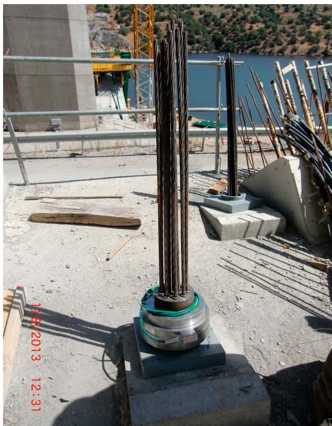
Figura 1. Célula de carga en anclaje al terreno.
