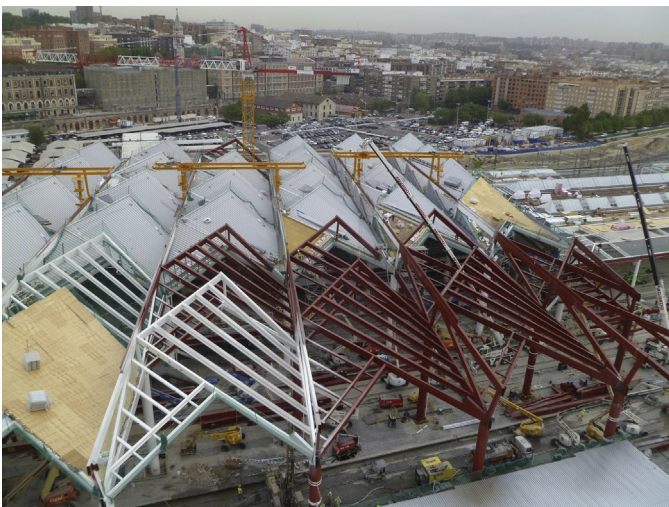
Figura 51. Puentes grúa sobre la cubierta alta.
