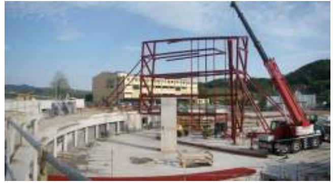
Figura 23. Montaje del primer sector de estructura en altura, compuesto por dos paños opuestos de celosía y las vigas y soportes intermedios.
