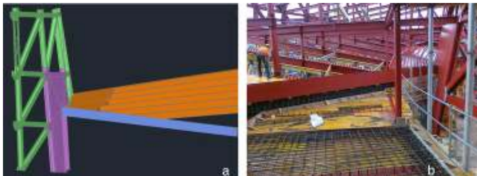
Figura 19. Refuerzo de chapa en el forjado de fondo. Imagen de la modelización 3D (a) y fotografía de la ejecución (b).
