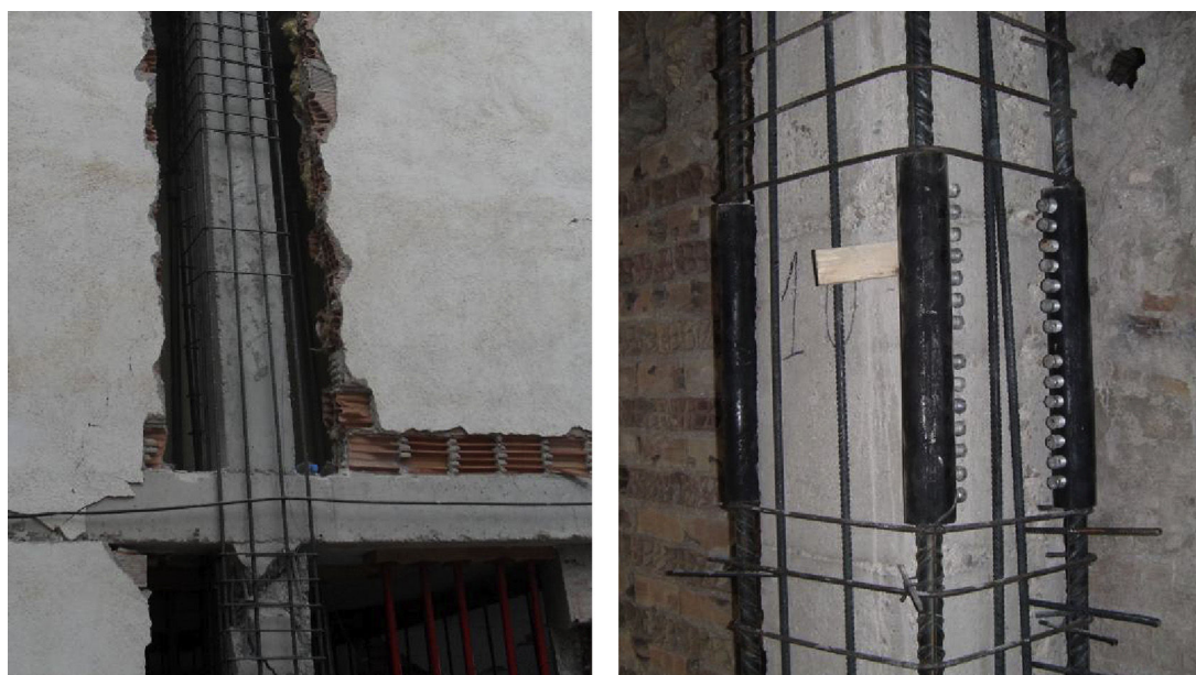
Figura 12. Continuidad de la armadura (refuerzos ejecutados tras el sismo en Lorca).
