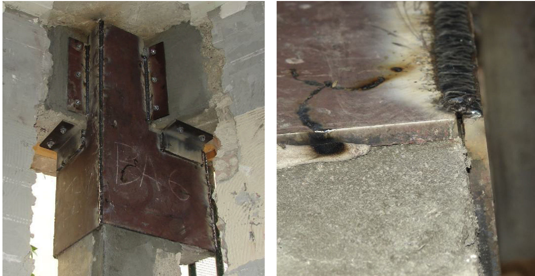
Figura 8. Detalles incorrectos en zunchado de pilares (refuerzos ejecutados tras el sismo en Lorca).
